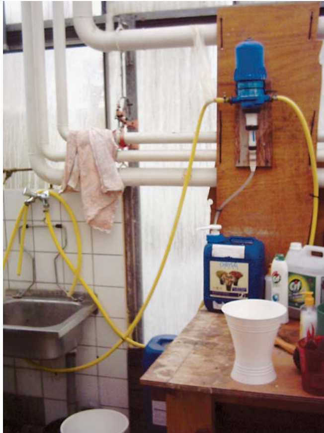
Figuur 1.4 Een speciale kraan met doseerpomp
